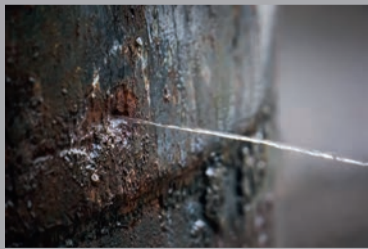
Kleines Loch mit großen Folgen – zum Beispiel in alten Trinkwassererwärmern.
