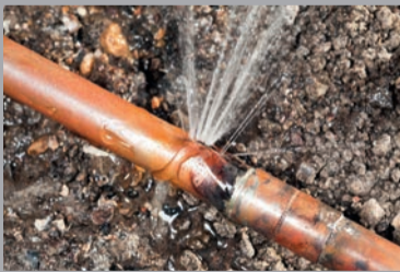
Lochkorrosion ist eine der häufigsten Ursachen für den gefährlichen Rohrbruch.
