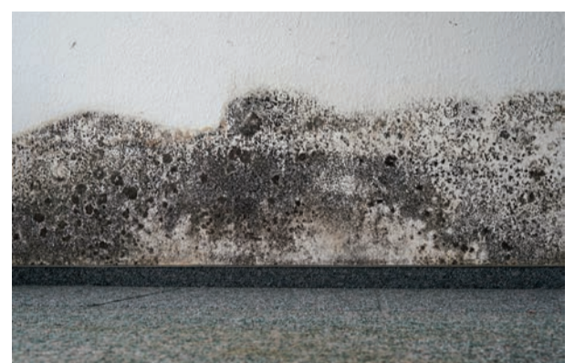
Schleichende Gefahr: Gesundheitsgefährdender Schimmel bildet sich sehr schnell.
