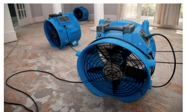
Haus oder Wohnung sind nach einem Wasserschaden für eine lange Zeit unbewohnbar.
